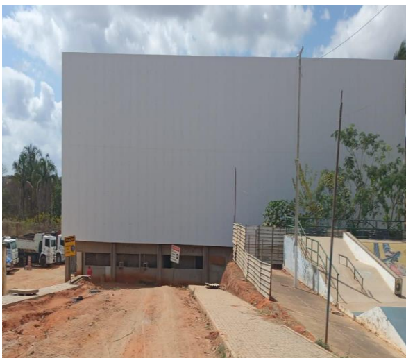
Figura 5 - Construção da piscina semiolímpica alocada no interior do Parque Natural Municipal das Timbaúbas
